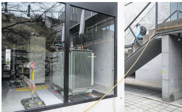
In diesen unscheinbaren Betonbau kommen schon bald die grossen Speicherbatterien.
