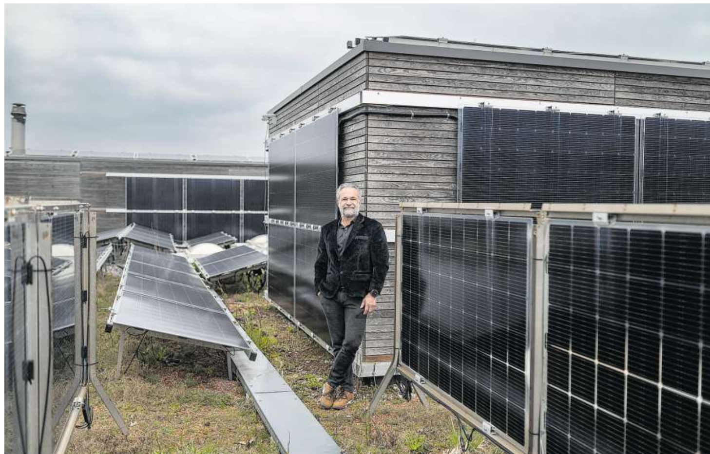
Geschäftsführer Fabian Möckli auf dem Dach des Fitness Island in Bronschhofen – umringt von Solarzellen.
